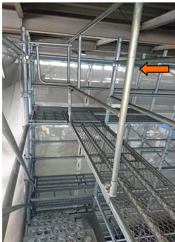
タラップガード(階段開口部手摺)参考写真1
