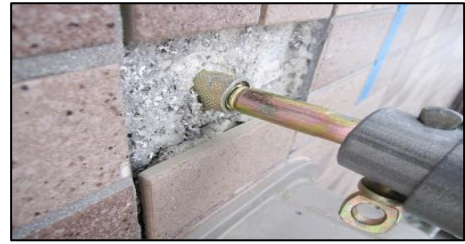
壁つなぎ取付け端部
